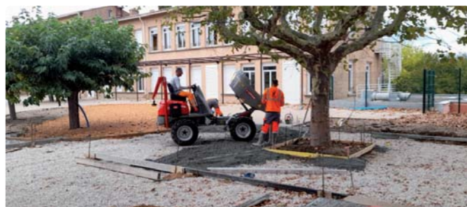
28 août: dernières coulées de béton drainant face à la cantine et autour des platanes... plus aucun engin ne pénétrera dans la cour
