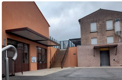
Bibliothèque, cyber-espace et salle polyvalente Pose d'auvents à l'entrée des deux bâtiments . Installation d'un escalier de desserte de l'école élémentaire Les Ocres vers la bibliothèque et le cyber espace.
